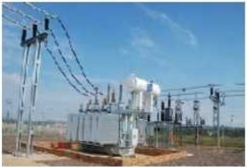
Rede nacional de energia a caminho de Nauela
